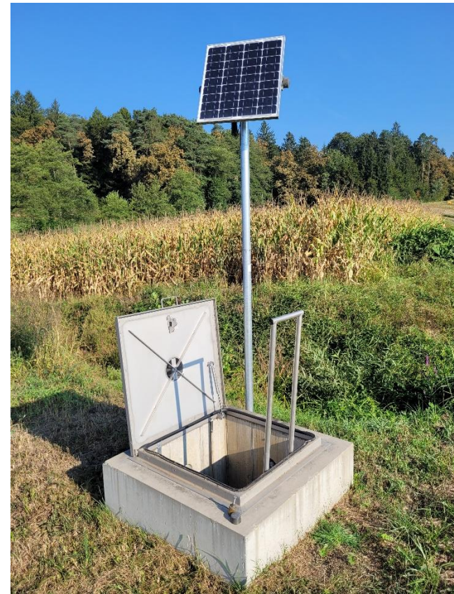
Außenstation mit Solarpanel zur Stromversorgung
